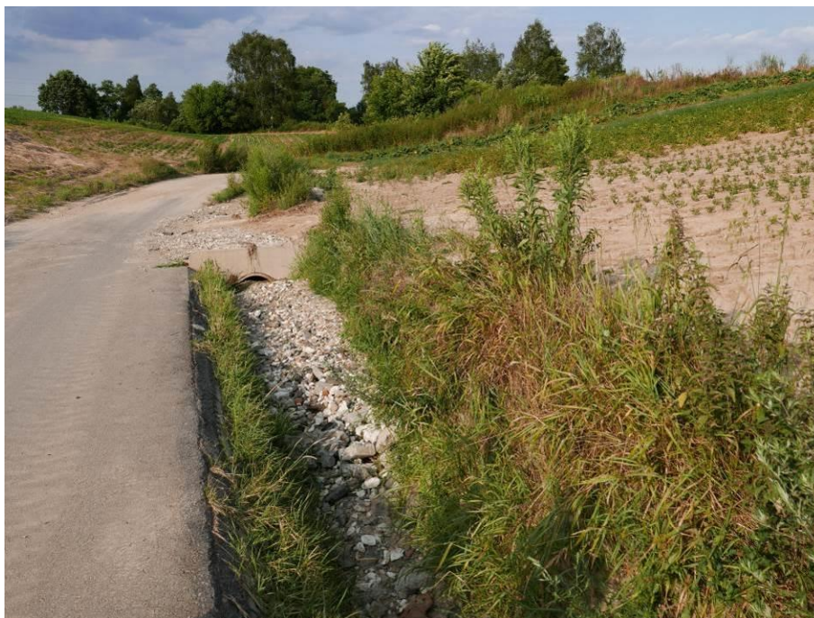
Fot. 54. Całkowite zasypanie koryta ciek
