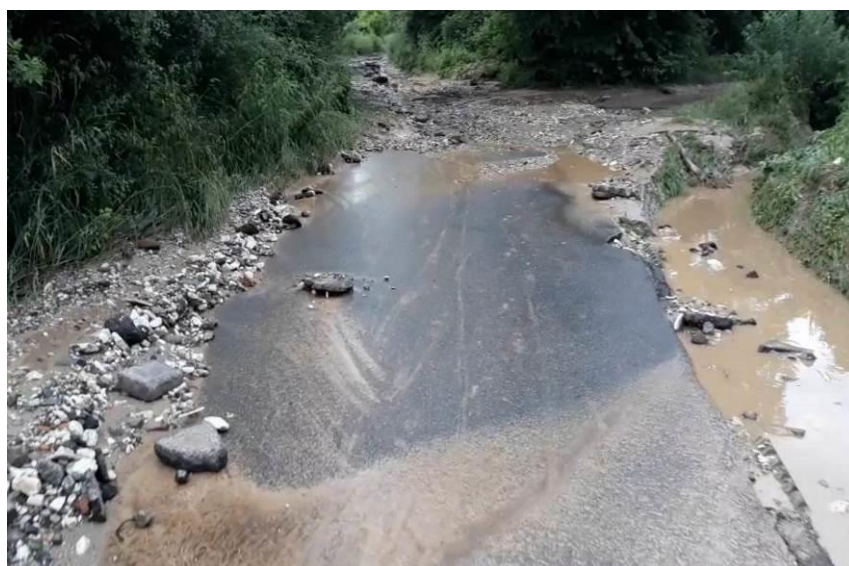
Fot. 49. Zniszczenie infrastruktury po powodzi – Rada Sołectwa Kończyce, 21.06.2019r.
