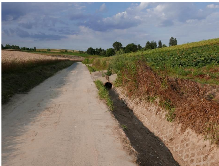
Fot. 56. Częściowe prace oczyszczające w korycie po wezbraniu
