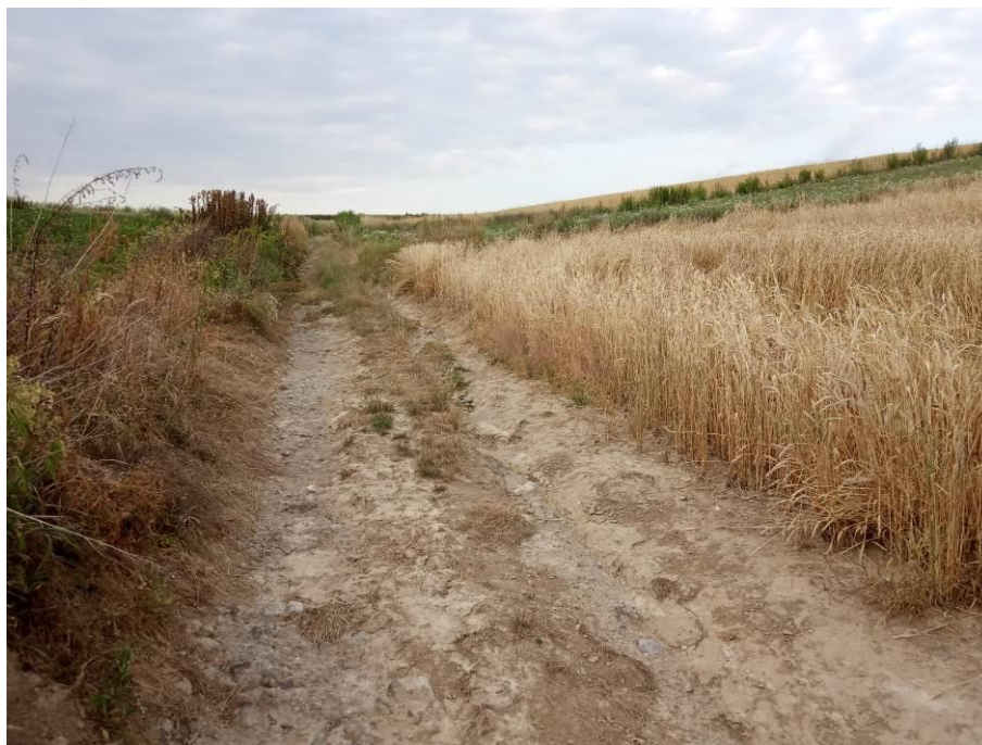
Fot. 32. Zerodowana droga dojazdowa do pól w odcinku górnym zlewni nr 4
