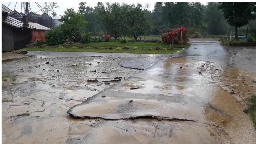
Fot. 62. Dewastacja infrastruktury drogowej – Rada Sołectwa Kończyce 21.06.2019
