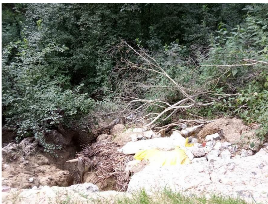
Fot. 37. Oberwanie skarpy i drogi dojazdowej do wąwozu
