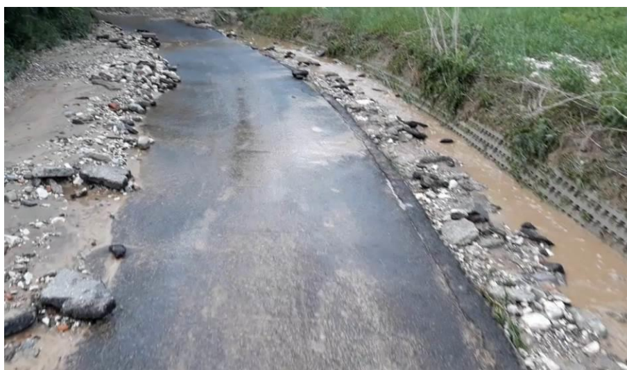
Fot. 51. Zniszczenie infrastruktury po powodzi – Rada Sołectwa Kończyce, 21.06.2019r.
