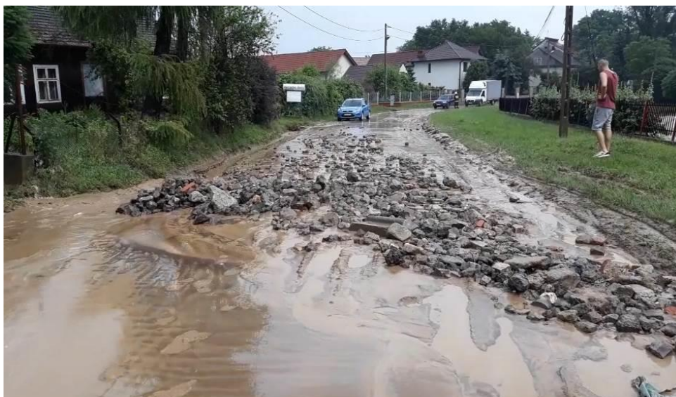
Fot. 63. Dewastacja infrastruktury drogowej – Rada Sołectwa Kończyce 21.06.2019
