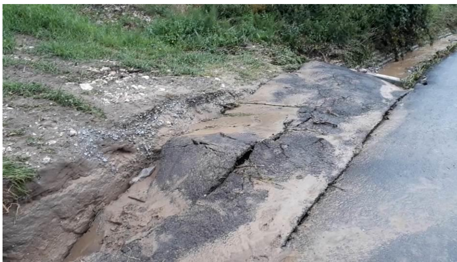
Fot. 53. Zniszczenie infrastruktury po powodzi – Rada Sołectwa Kończyce, 21.06.2019r.
