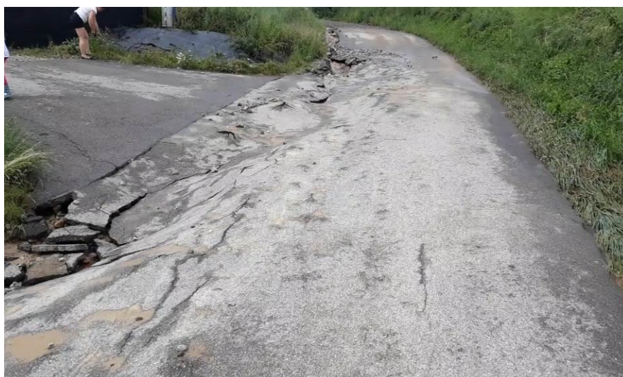
Fot. 81. Dewastacja infrastruktury drogowej – Rada Sołectwa Kończyce 21.06.2019
